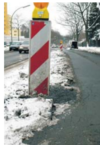
Werden die Schlaglöcher zu groß und zu tief, werden, wie hier in der Arnulfstraße, Warnbaken aufgestellt.
